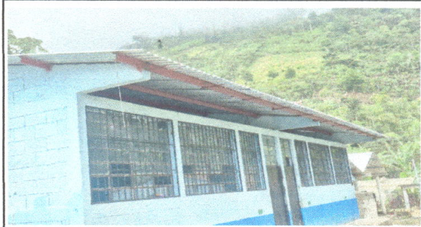
Foto 4: CAMBIO DE LAMINA NORMAL A LAMINA TROQUELADA.
